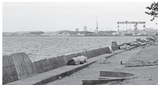
崩壊した福浦岩壁
